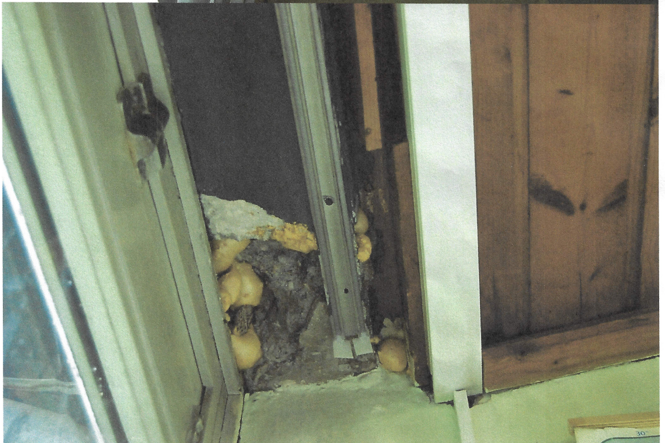
Na vogalnem stropnem delu je odstopil beton. S PUR peno smo začasno zamašili luknje.
