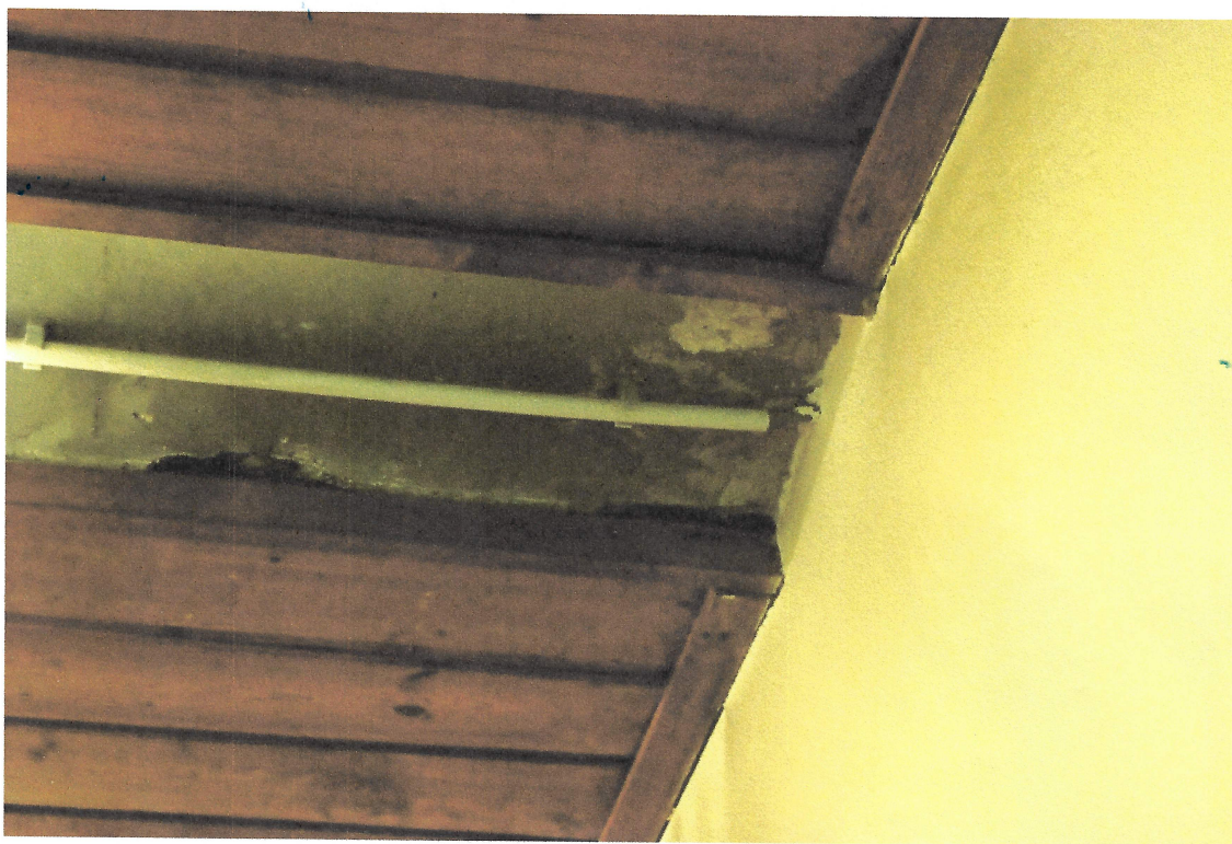
Strop v učilnicah ima luknje, skozi piha, ker pod opažem ni izolacije. Aluminijska električna napeljava je bila zamenjana leta 1989 in je napeljana nadometno.
