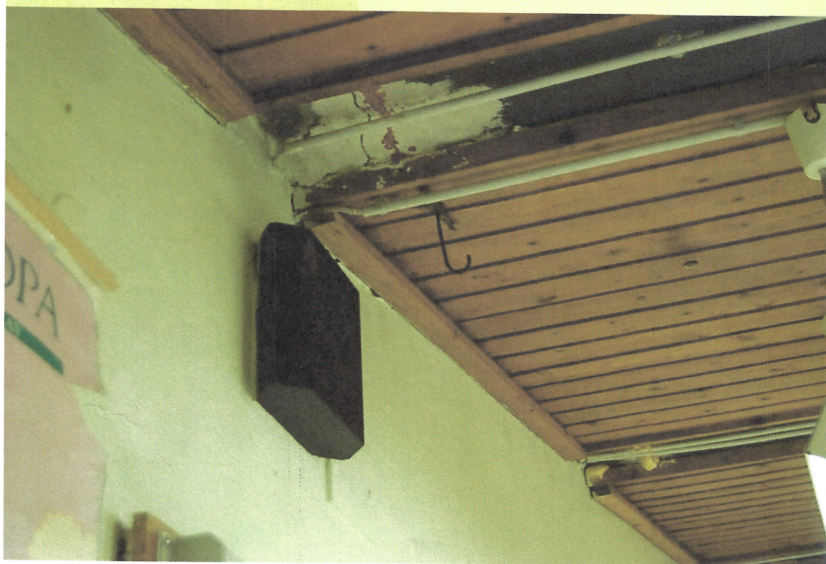
Počen beton na konstrukciji stropa se kruši in pada v učilnico.
